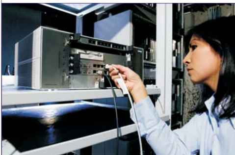
Nebenstellenanlage Siemens HiPath 4000
