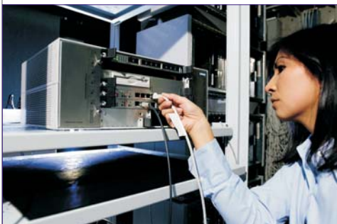
Nebenstellenanlage Siemens HiPath 4000
